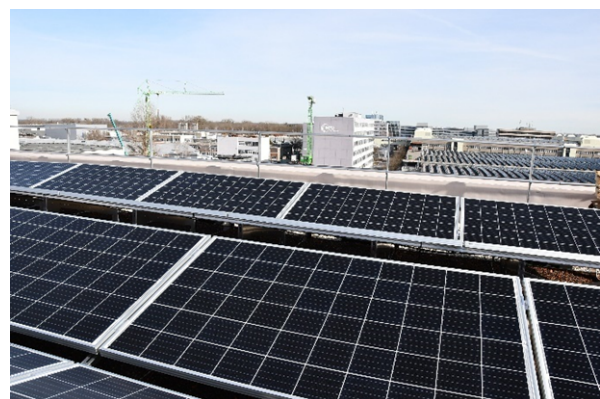
Abbildung 7: Photovoltaik Anlage auf den Dächern der MTU Aero Engines in München.
